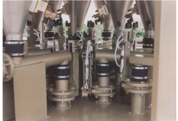
Abb. 2: Dosierschnecken mit Flanschmotoren und Rüttler an den Behälterschragen Elektromechanische Schnellschlußklappen an den Dosierelementen
